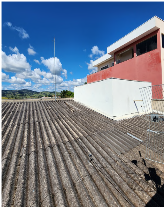
Figura 32 – Serão reparados as telhas de fibrocimento encontradas na cobertura.
