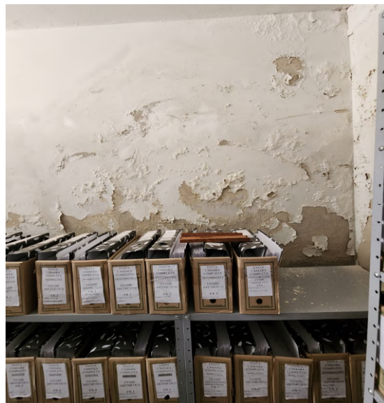
Figura 20 – Dentro da garagem, serão refeitos os acabamentos das paredes e tetos. Em todas as paredes serão demolidos a argamassa para impermeabilização com aditivo recomendado.
