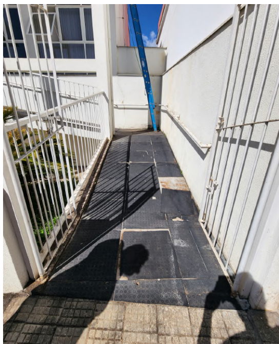
Figura 21 – Na rampa serão removidos os pisos emborrachados existentes e construídos um novo piso tátil de acordo com o memorial descritivo e planilhas orçamentárias.
