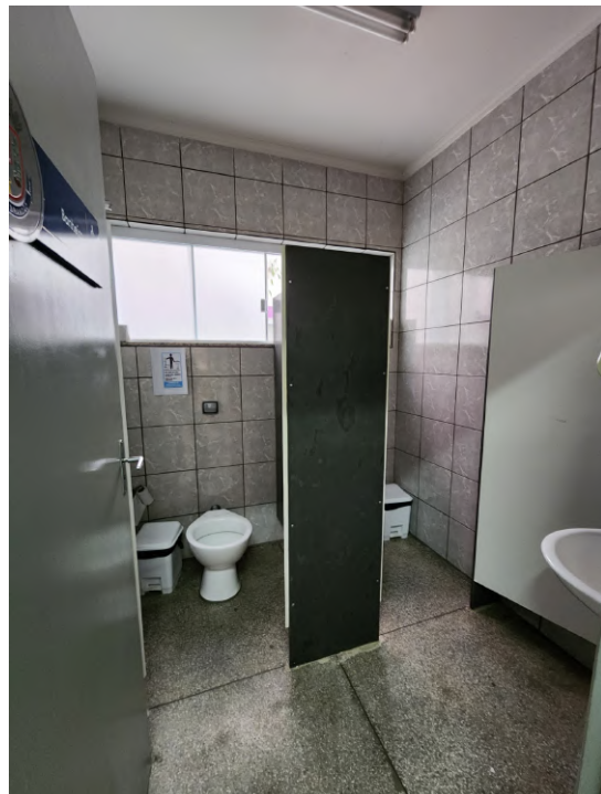
Figura 12 – Nos dois banheiros térreos, serão demolidos as louças, divisórias e porta de acesso, para adaptá-los como banheiros PNE; instalando barras de apoio e porta recomendada pela NBR 9050.
