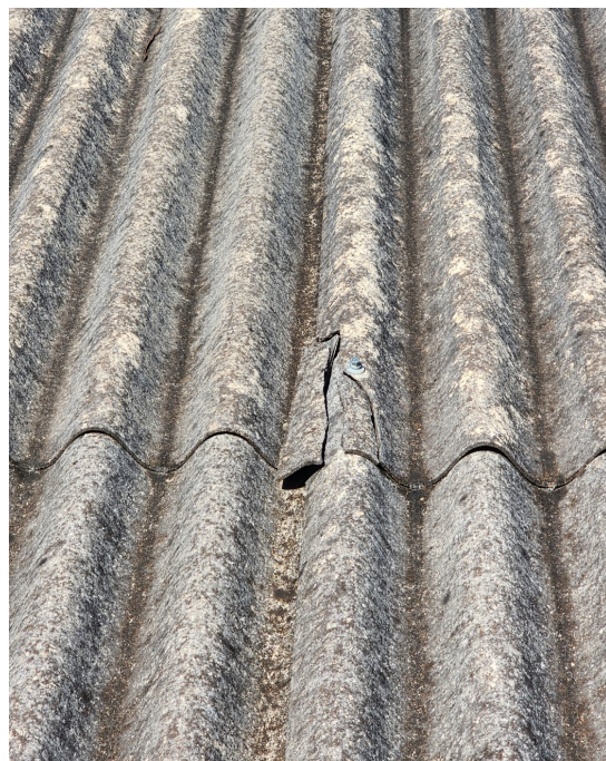
Figura 33 – Serão reparados as telhas de fibrocimento encontradas na cobertura.
