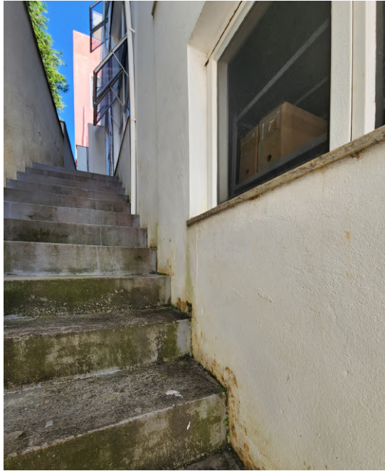
Figura 30 – A escada do corredor lateral que dá acesso ao Almojarifado será revestida com porcelanato cerâmico adequado para áreas externas.
