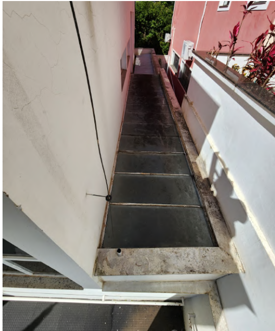
Figura 34 – O telhado de policarbonato será instalado um rufo metálico na lateral esquerda e realizado sua limpeza.
