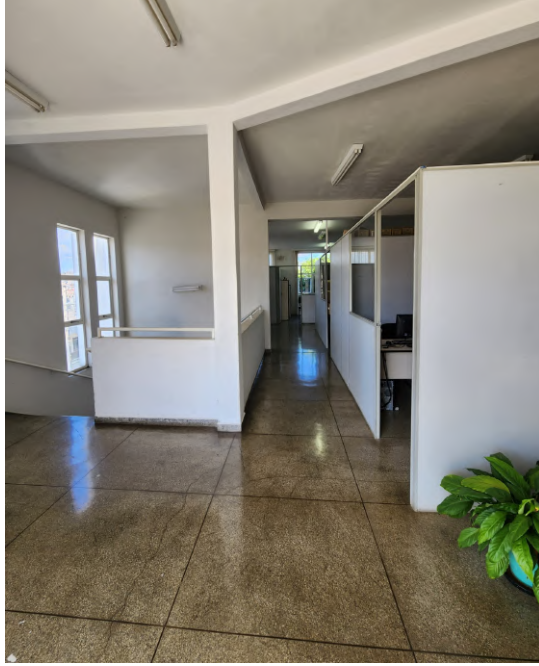
Figura 5 – Guarda da Corpo da escada a ser demolido para construção de um adequado as normas da NBR 9050 e Corpo de Bombeiros de Minas Gerais.
