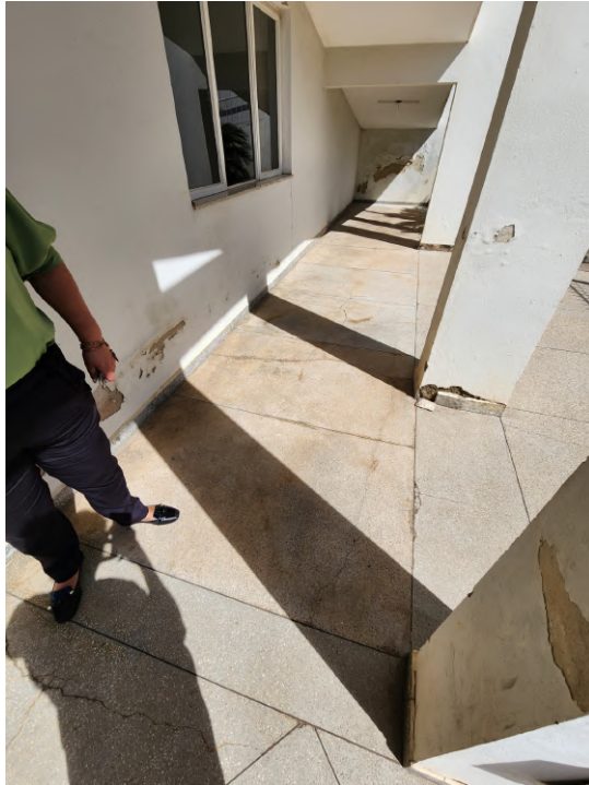
Figura 26 – No piso externo, deverá ser realizado a regularização do nível do piso com massa antes do assentamento do porcelanato.
