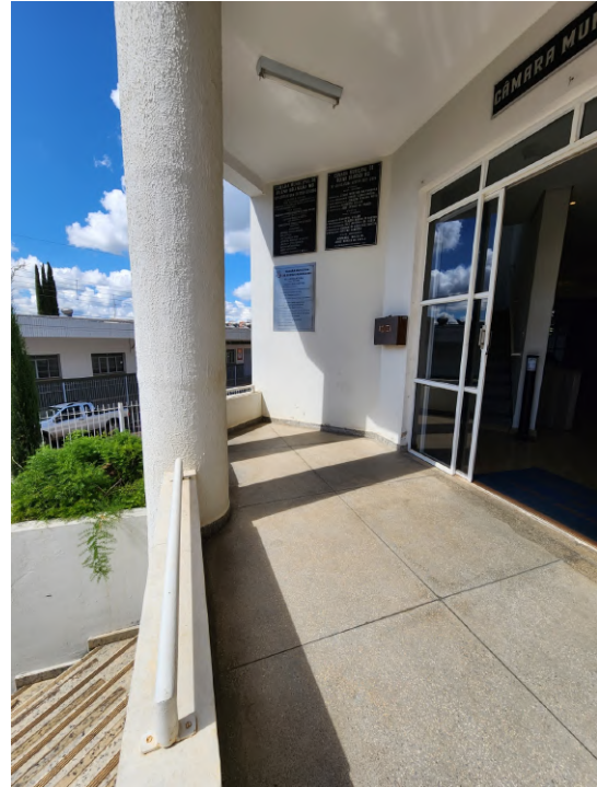
Figura 27 – Na parede ao lado da porta de entrada deverão ser instalados pontos elétricos, tomadas, de acordo com o projeto elétrico.
