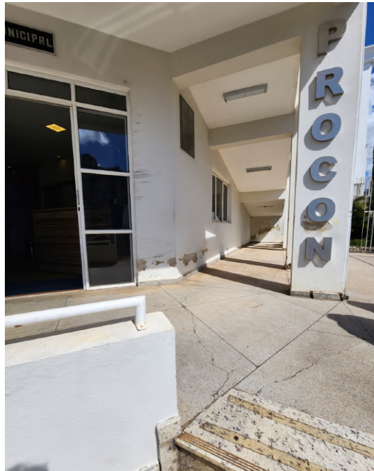
Figura 25 – Será realizado a construção de um porcelanato cerâmico externo sobre o granilite existente.
