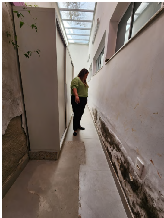
Figura 16 – Dentro da área de serviço, serão refeitos os acabamentos de parede na altura de 1,50 m do piso, com impermeabilizante recomendado.
