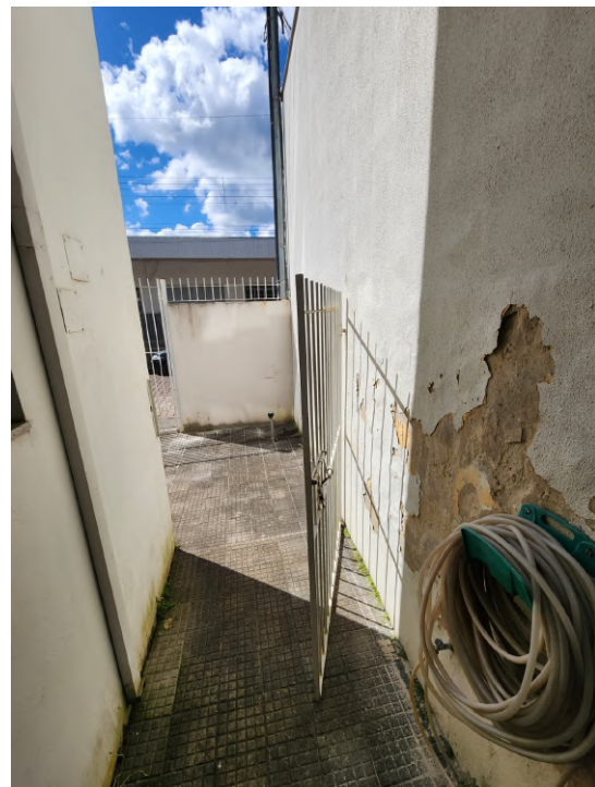
Figura 29 – Nos pisos externos laterais será assetado o porcelanato cerâmico, sendo realizado a limpeza e regularização do nível com massa antes da execução.
