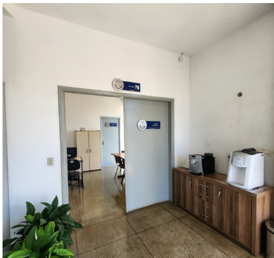
Figura 1 – Porta P9 a ser demolida, para construção da Porta P6 junto a recomposição da alvenaria e acabamento da parede.
