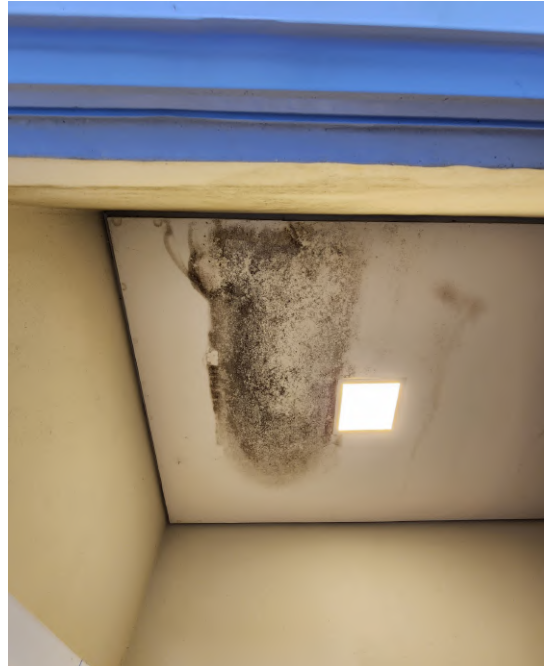
Figura 18 – Dentro do almoxarifado, o forro de gesso está com infiltração, deverá ser lixado e pintado. A calha do telhado acima deverá ser revisado visando a origem da infiltração.
